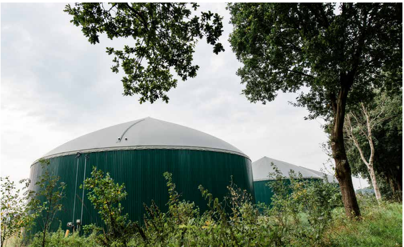
Externer Biogasreaktor – aus dem Blockheizkraftwerk zur Verstromung des Gases geht der Wärmeanteil in den Standort Varel.
